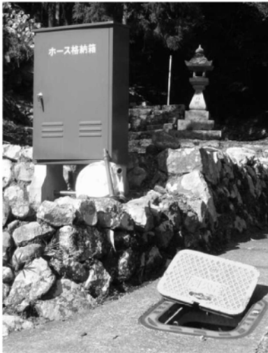
簡易給水施設に設置した消火栓 (洞尾)
