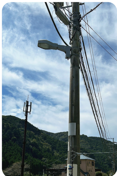
設置された防犯灯（月野瀬地区）
