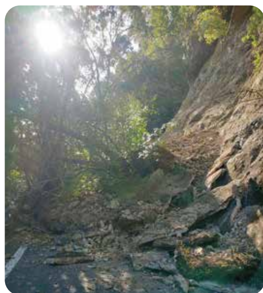
下露の山崩れ (県道)
