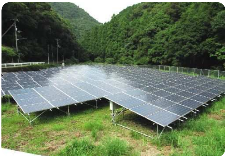
稼働中の太陽光発電（三尾川）
