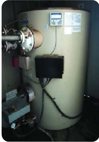
取替前のボイラー（ほたん荘）
