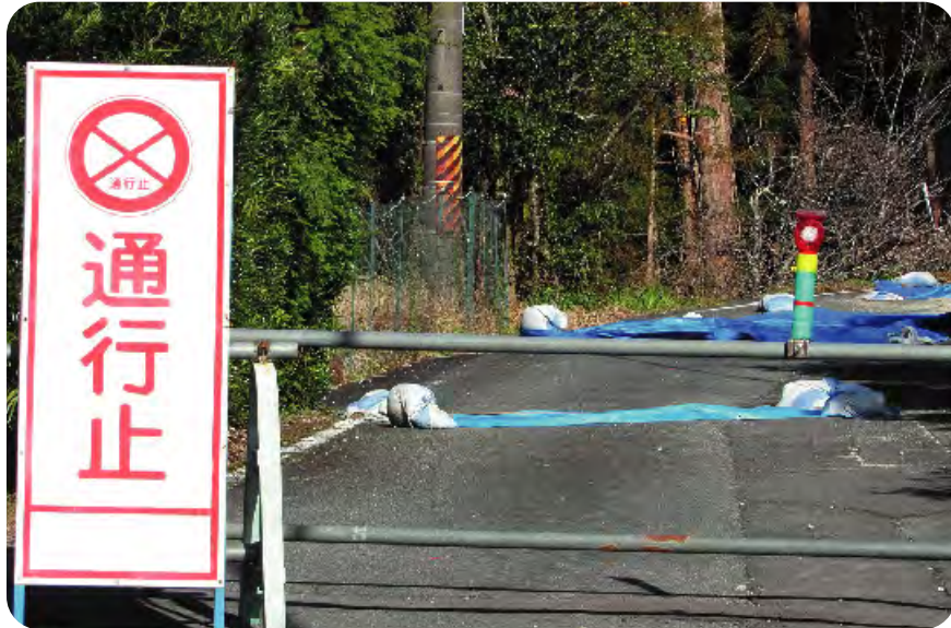
通行止めが続く平井の町道
