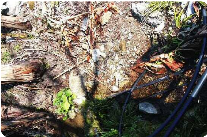
簡易給水施設
