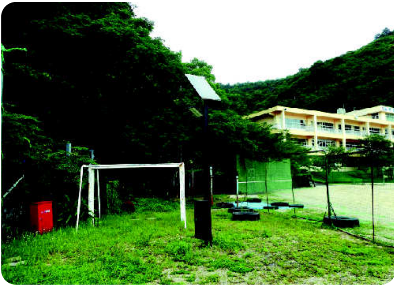
古座中学校付近の避難誘導灯
