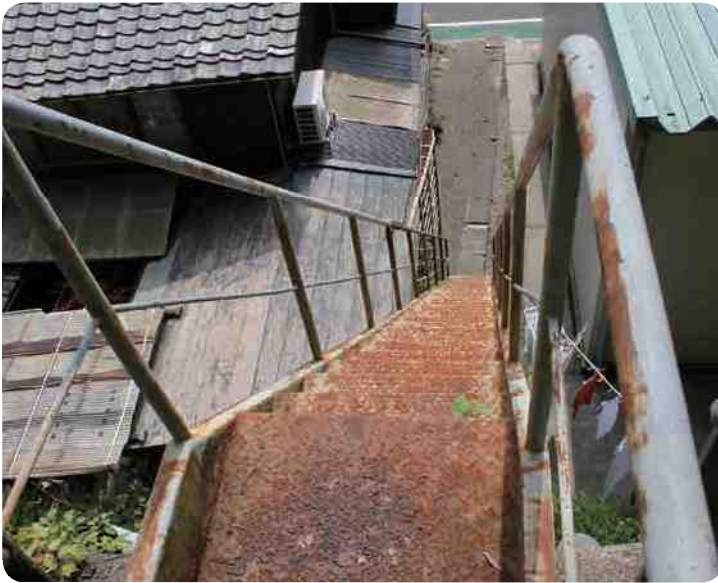
避難階段（高池下部消防車庫裏）
