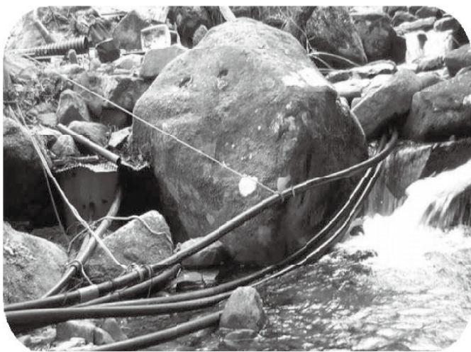
不安定な取水口（平井）
